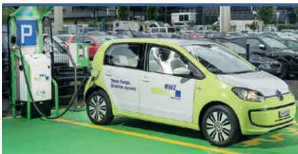
Erste öffentliche Schnell-Ladestation in Zürich (ewz)
